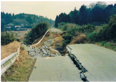
芝山町菱田の町道 (80年に亘って道路が陥没)
